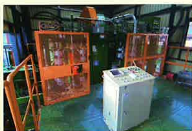
↑オペレーター室
